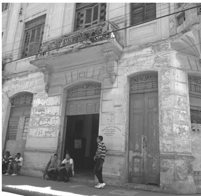
Fachada en mal estado. Empresa de Comercio y Gastronomía
