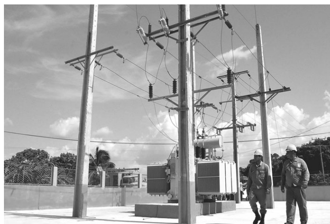
Media Luna tiene una segunda Subestación Eléctrica que permitirá disminuir el tiempo de interrupción al cliente
