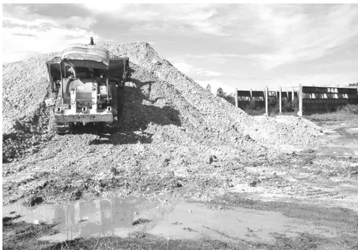
Actualmente se trabaja en el descortezado de la capa vegetal, para edificar la planta de bioplaguicidas y biofertilizantes
