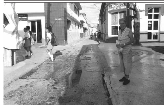
En la calle Masó, esquina al Paseo de General García, en Bayamo, existe un salidero hace algún tiempo, aparece en los días que toca agua para esa zona
