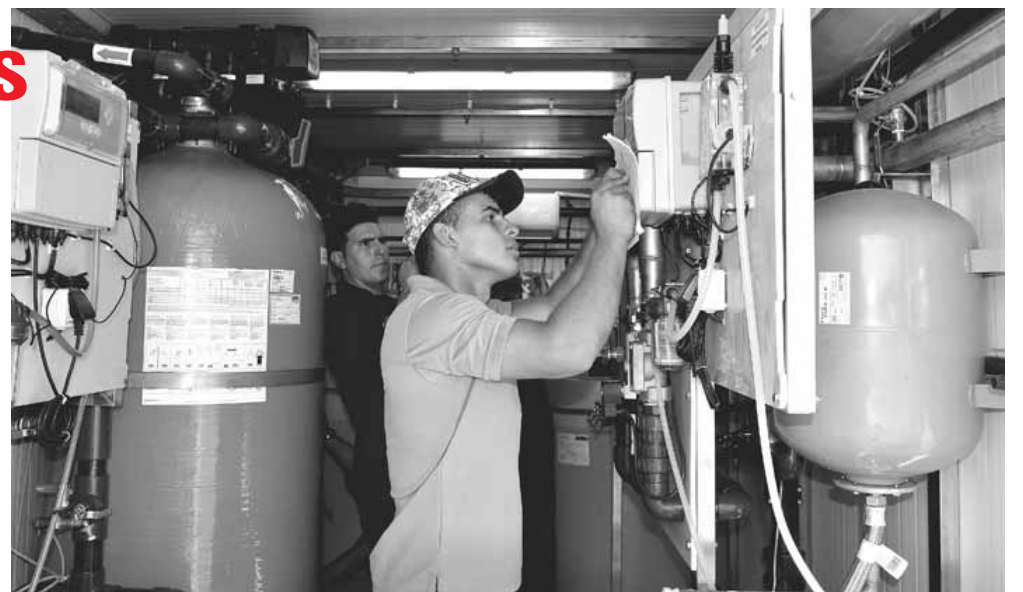
La planta desaladora instalada en el barrio rural El Salvial, de Cauto Cristo, suministra agua de elevada calidad a los lugareños
