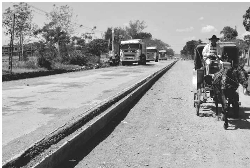
Señales visibles y varias, iluminación, delimitación, desvío de la circulación de medios..., cualquier medida de precaución de transeúntes, autoridades de Tránsito y de la entidad constructora, bien vale la pena.
