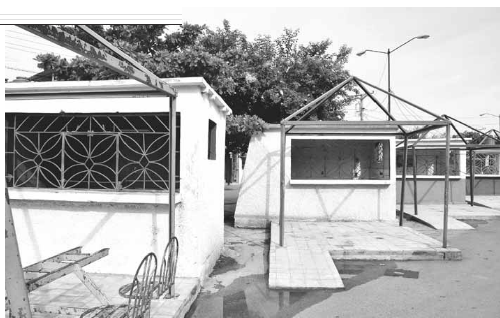
En deplorable estado se encuentran los quioscos de los cuentapropistas, ubicados en las inmediaciones de las terminales de ómnibus y ferrocarril en Bayamo, una de las zonas más transitadas de la urbe
