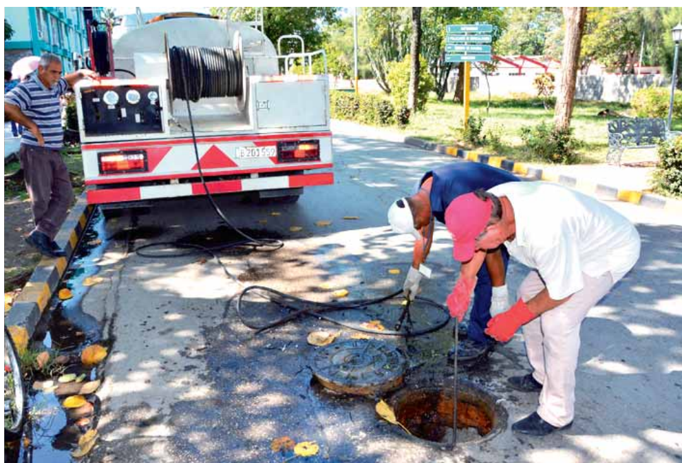
Granma cuenta con cinco carros de alta presión para desobstrucción de alcantarillas
